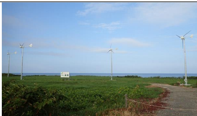
遠別町の海岸沿いに建設された小型風車
